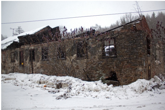
Abbildung 1: Die Stoßherdwäsche einen Tag nach dem Einsturz [F.: Kugler, 12.12.2010]
